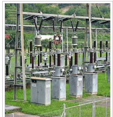
Installation pour le couplage d'un CPL sur un poste électrique 110 kV. On voit les circuits bouchons suspendus au portique et les condensateurs de couplage à leurs pieds
